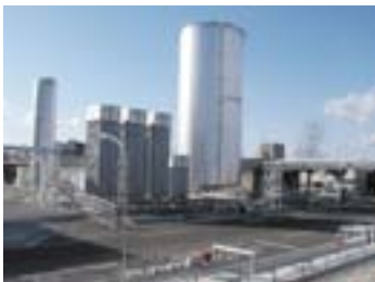
岡山事業所 天然ガス貯蔵設備
