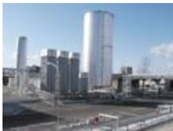
岡山事業所 天然ガス貯蔵設備
