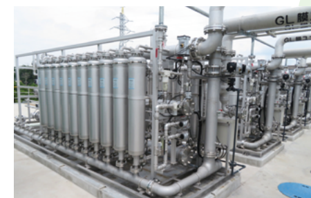
クラレ倉敷事業所内に設置した<ピューリア>GL
