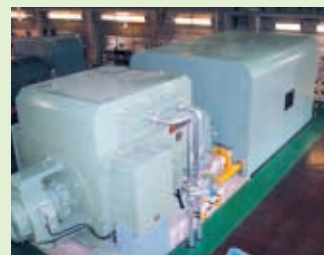
新潟事業所復水発電設備
