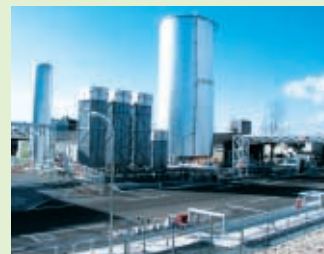
岡山事業所天然ガス貯蔵設備
