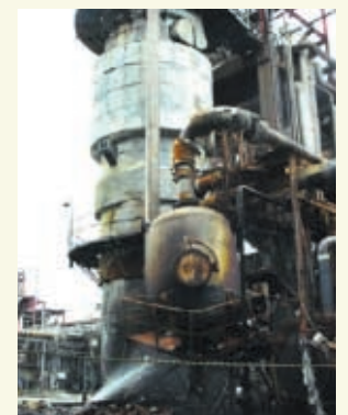
爆発の影響で損傷を受けた反応器周辺
